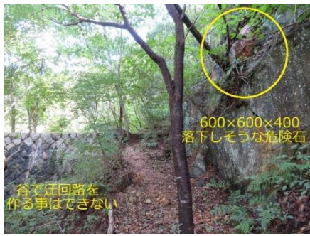
白瀬川源流ルート側壁の木の根元に 大落石が乗りかかっていた
