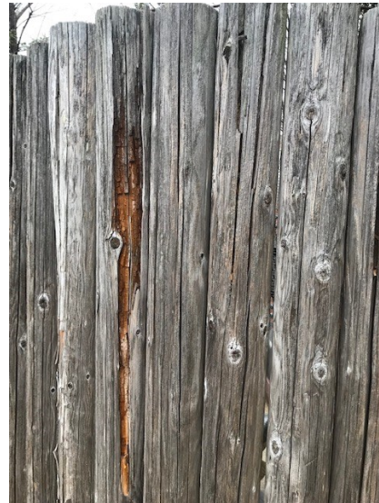
殆どの材木が朽ちている
