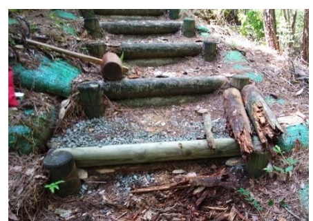
ゆずり葉ピークからの下り坂 腐食した木製階段の改修テスト
