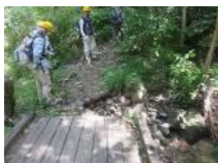
エントランス広場木橋 基礎の石垣崩壊
