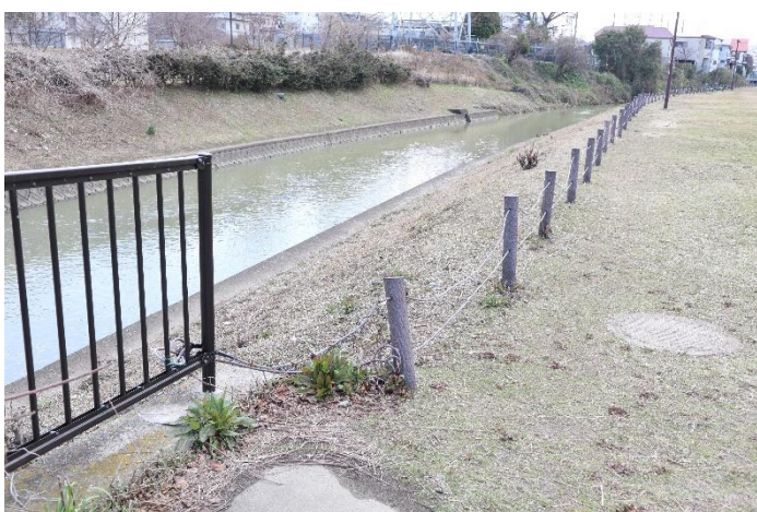
⑳橋の南西側落下防止柵を撮影
